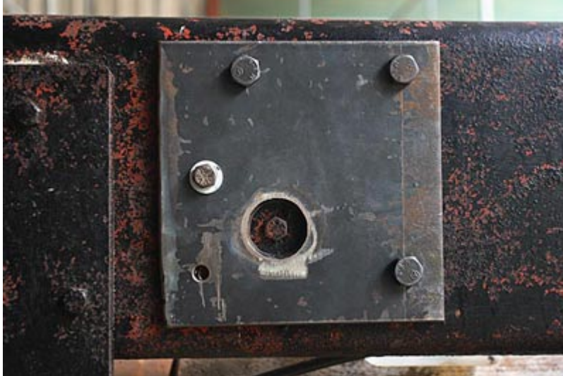
Gros plan sur une ferrure. Remarquez le joli trou au dessus d'un boulon. Mon découpage à l'oxy s'améliore.
