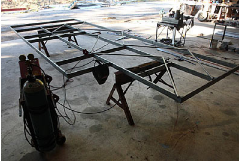
La structure en cours de construction. Remarquez les renforts provisoires qui empêchent la déformation des angles droits pendant la soudure.
