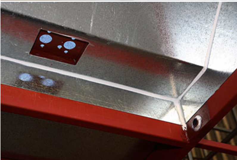
Et vue de l'extérieur. La durit de gazole et le câblage de la pompe passent par le trou dans la structure, à droite.
